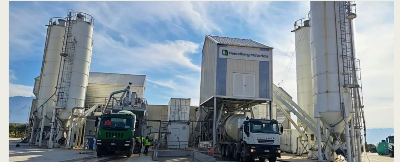
Impianto di calcestruzzo di Campagna (SA)
